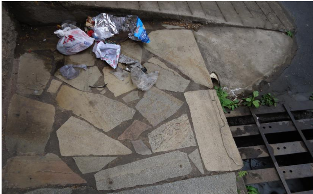
Figura 24: Lixo retirado em bueiro de rua que sofre problemas de alagamento pluvial. FONTE: Acervo pessoal
